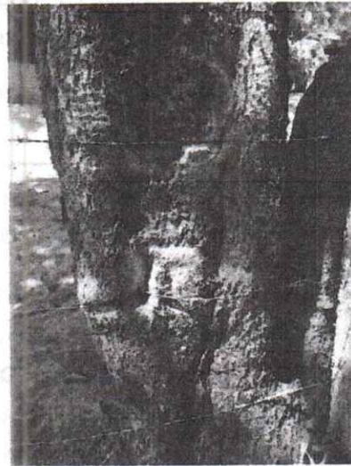
Foto 2. Vista lateral-frontend del daño en los troncos.
